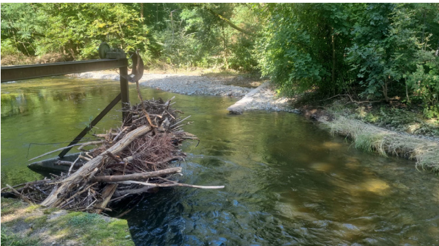
Poškozený jez v Burku
