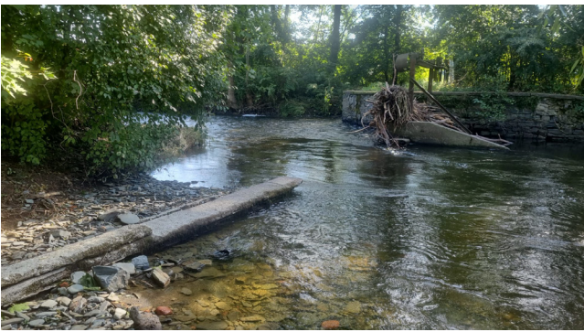
Poškozený jez v Burku
